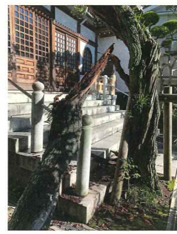
台風で崩落した枝(令和元年10月撮影)
